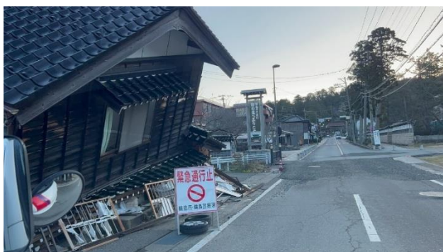
倒壊した家屋の横を慎重にすり抜け移動（車窓より）
